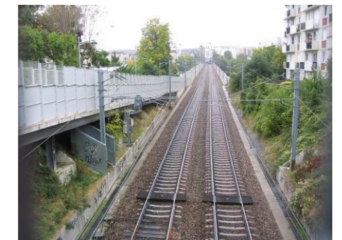
Figure 349 : Section rénovée à travers béton à hauteur de Saint-Germain-en-Laye (RN13 - Bel Air)
